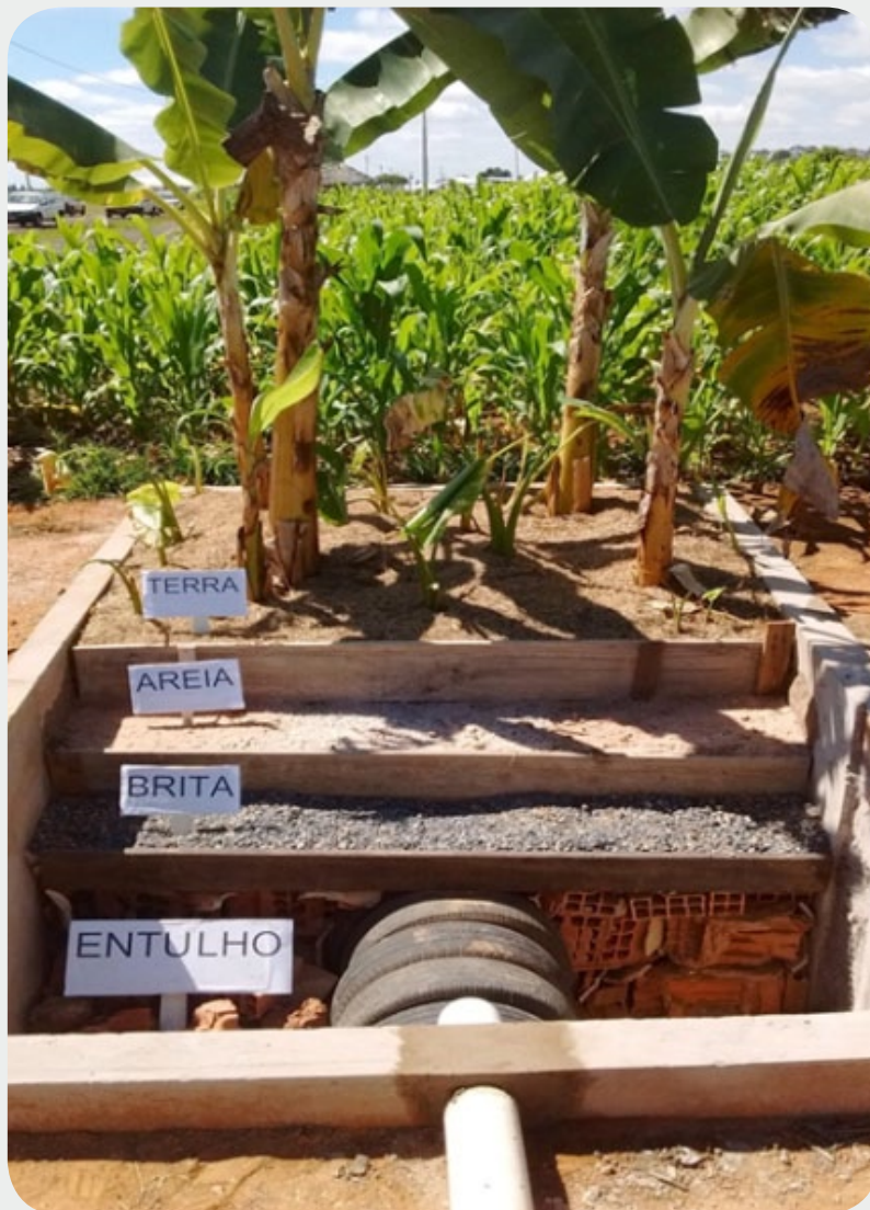
Figura 1. Exemplo de tanque de Evapotranspiração. Fonte: Emater-DF
